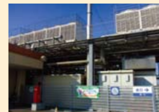
コジェネレーションシステム
