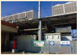
コジェネレーションシステム
